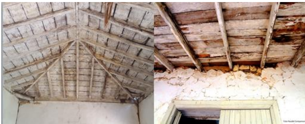
Figura 2. Deterioro de la cubierta de madera. Fuente: Elaboración propia
