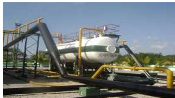
Figura 3: Vista exterior del separador horizontal de medición.
