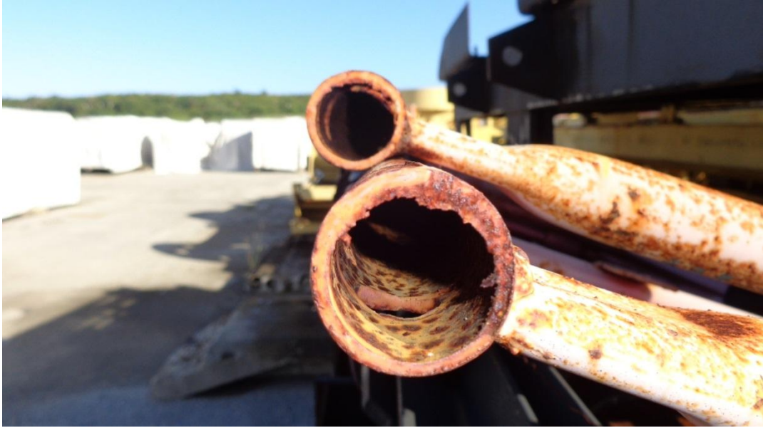
9.-Preparación superficial incorrecta
