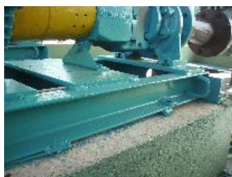
Fig.6 Base de los motores.
