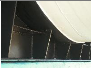
Fig.7. Base de los tanques de Combustibles.
