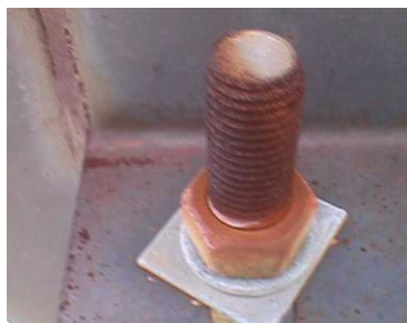
Fig.3.12 Falta de protección en pernos, tuercas y arandelas.
