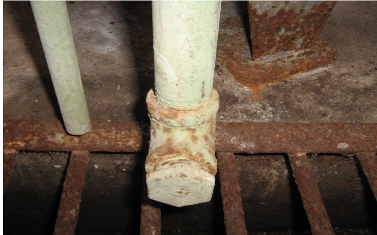
Fig. 16. Observe descargas inadecuadas que provocan salpicaduras sobre el equipo.
