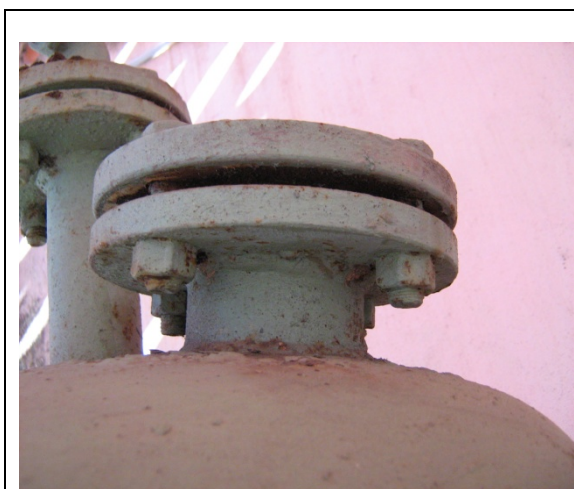
Fig. 4. Accesibilidad. Observe el espacio entre las dos bridas, tiene una separación menor que 50 mm.
