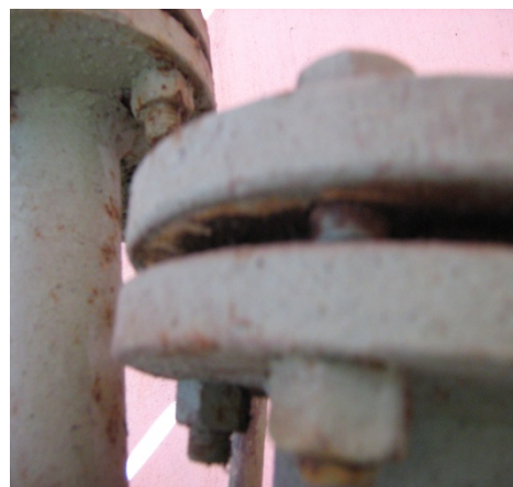
Fig. 5. Accesibilidad. Observe la corrosión sin pintura en su interior no protegido.
