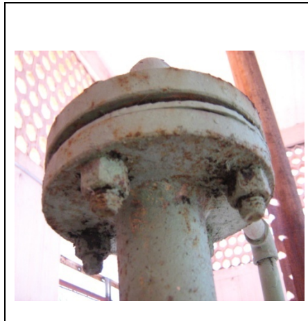
Fig. 13. Problemas en las uniones con pernos. Observe la falta de recubrimiento y la corrosión.
