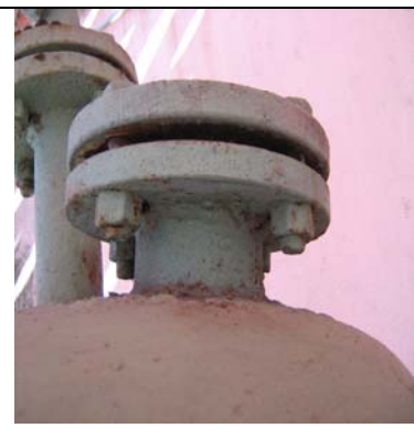
Fig. 6. Resquicios entre el perno y la brida y entre las bridas. Ver la separación entre bridas.
