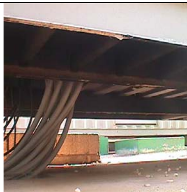
Fig. 2. Parte inferior del piso de contenedores. Presenta problemas de accesibilidad.
