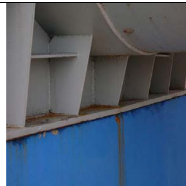
Fig. 3. Orificio en la unión hormigón – acero de la base. Observe la mancha de corrosión.
