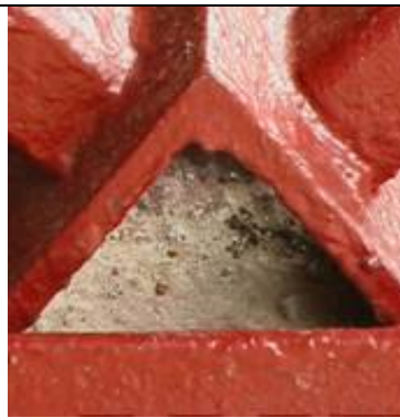
Fig. 8. Estructura de un Hotel, donde se observa la acumulación de agua y depósito sin drenaje.
