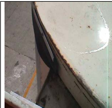
Fig. 7. Techo de Pasillos Telescópicos Aeropuertos con mal diseño. Observe la acumulación de agua.
