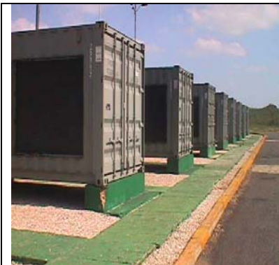
Fig. 1. Contenedores del Motor y Generador de una Central Eléctrica Diesel.
