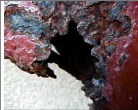
Fig. No. 27. Viga de sección rectangular hueca perforada por la corrosión desde el interior de la misma.
