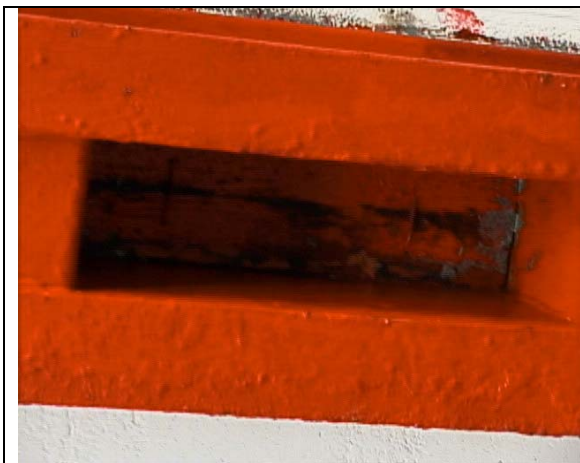
Figura No 1. Área inaccesible entre dos vigas canales. Por el espacio reducido que no cumple las normas, no es posible ejecutar las labores de protección anticorrosiva, quedando esta área desprotegida y expuesta a la acción del ambiente.
