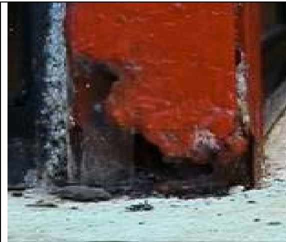
Fig. No 23 Aplicación inadecuada de la soldadura (soldadura discontinua), por lo cual se facilitó la penetración de la humedad y la acumulación de los contaminantes causantes de la corrosión.
