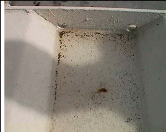
Fig. No. 21. Superficie sin inclinación ni drenaje donde se queda retenida el agua.
