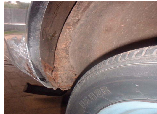
Fig. 6. Accesibilidad. Está es un área de difícil preparación superficial, además de facilitar la acumulación de depósitos y agua, por lo que hay que incrementar las medidas de protección.
