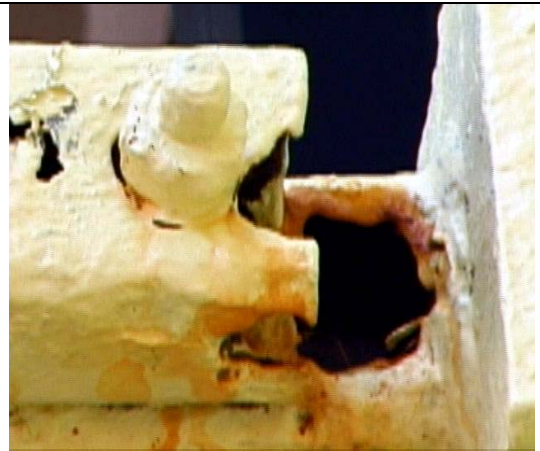
Fig. No. 28. Perfiles de sección cuadrada huecos sin ser sellados y sin protección interior.
