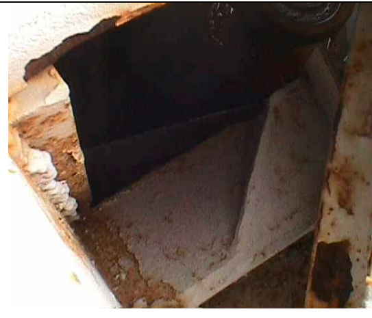
Fig. 4. Área cerrada inaccesible, donde no pueden ser aplicados recubrimientos de pintura y donde debe garantizarse una protección por el tiempo de vida físico del equipo.
