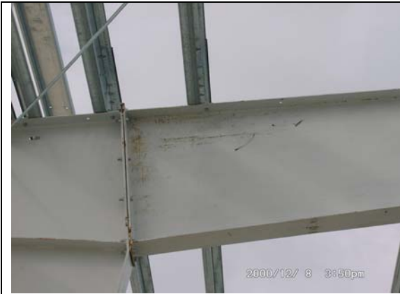
Fig. No 15. Mala manipulación de la estructura una vez elaborada, lo cual provocó el deterioro del recubrimiento de pintura.
