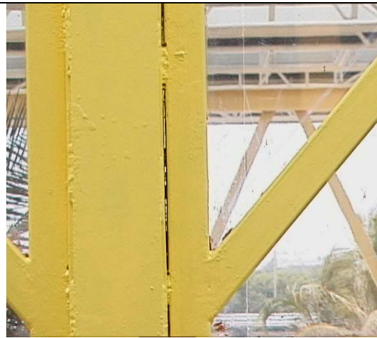
Fig. 24. Soldadura discontinua que favorece la acumulación de agua y contaminantes y formación de intersticios, donde no son fácilmente aplicables los recubrimientos.
