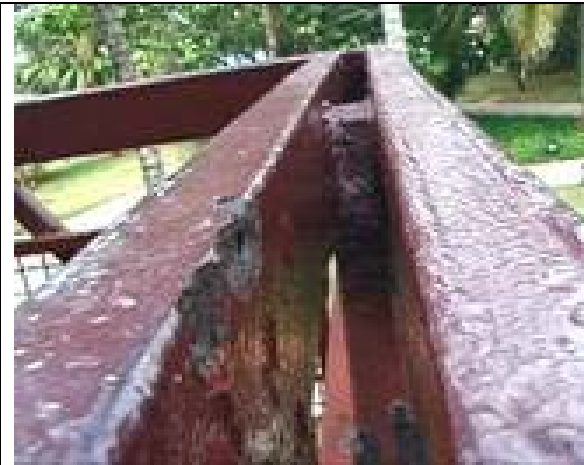
Fig. No 3. Como se observa en la figura, se tienen dos vigas de sección rectangular huecas paralelas con espacio insuficiente, por lo cual no es posible realizar una buena preparación de superficie y posterior aplicación del recubrimiento.
