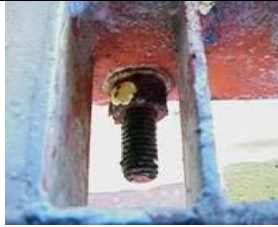
Fig. No. 26. Conexión con perno sin protección. Hay problema de accesibilidad.
