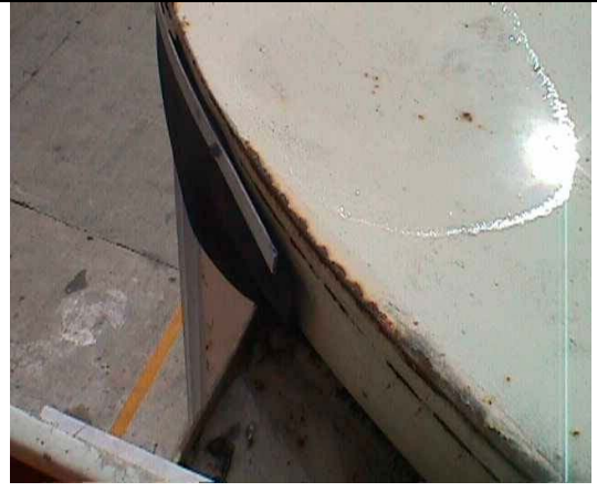
Fig. No. 22. Zona de acumulación y depósitos, con efectos de bordes que favorecen el deterioro del recubrimiento.
