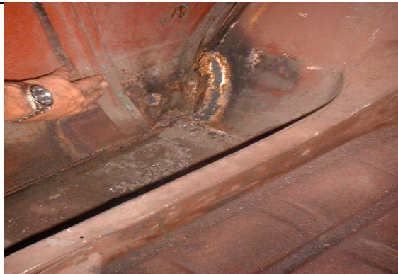
Fig. 5. Accesibilidad. Las bóvedas son áreas difíciles de preparar y mantener su sistema de pintura, por lo que hay que incrementar las medidas de protección, ya que está área no esta protegida por el tiempo de vida de la estructura.
