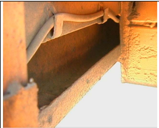
Fig. No. 14. Refuerzos con retención de depósitos y agua sin drenajes en la cama de un camión.
