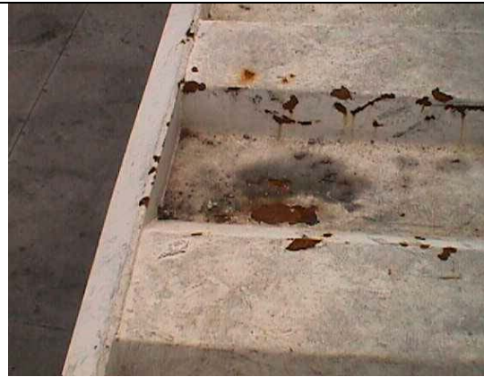
Fig. No 16. Golpes mecánicos durante los trabajos de mantenimiento que causan la destrucción de los recubrimientos de pintura, que además no fueron reparados.
