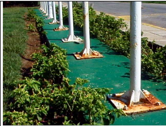
Fig. No. 13. Observe los refuerzos con retención de depósitos y agua, causa del deterioro por corrosión.
