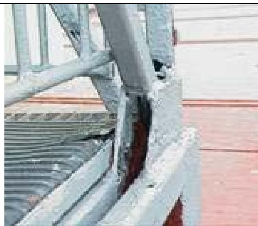
Fig. No 2. Cartabones paralelos sobre base soldada con separación inferior a los 50 mm que es el límite inferior que se establece por las normas. Se observa como el interior no se encuentra protegido.
